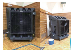
冷風機 2機設置
